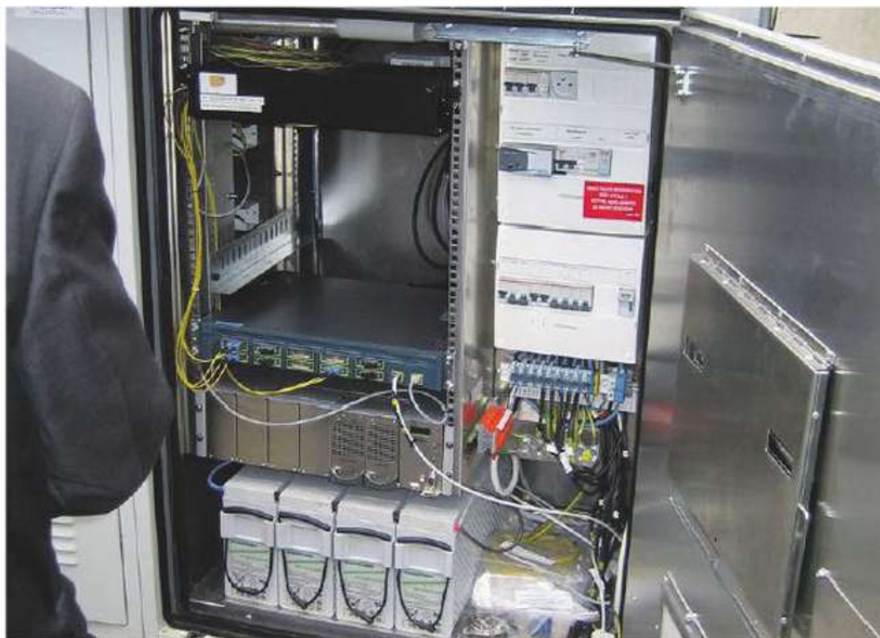
Des armoires sont installées un peu partout sur le territoire afin de raccorder les usagers à la fibre optique. © Photo d'illustration D.R.
